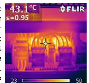
Abbildung 3 - Wärmequelle in einer Schaltgerätekombination
